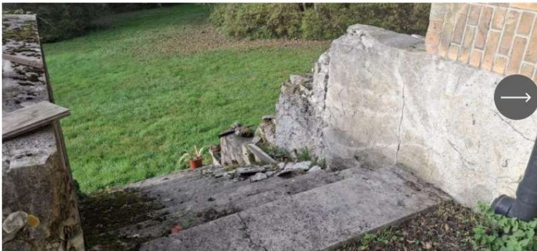
Les escaliers sont en mauvais état... - Fondation du patrimoine
